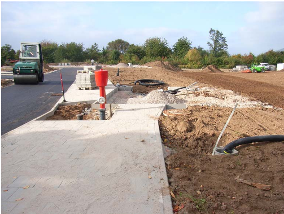
Zufahrt zum Hubschrauberflugplatz mit Löschwasserhydrant
